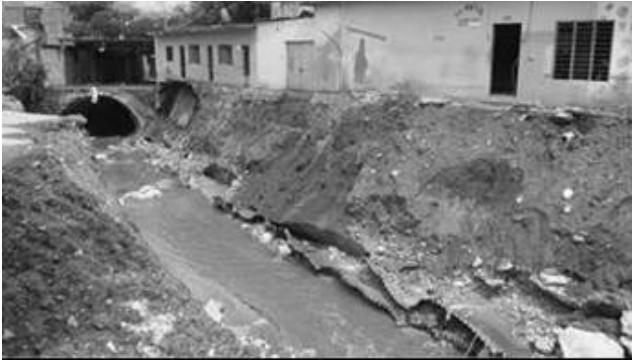
Foto 2. Embovedado colapsado en el arroyo San Roque (Mundo et., al, 2019b; Alvarado, 2016).
