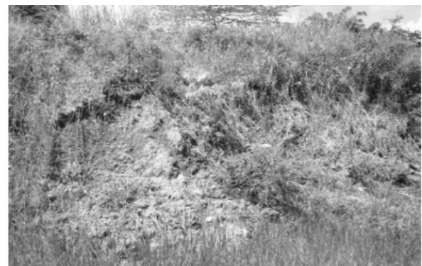
Figura 2. Deslizamiento del talud por desecación de la arcilla lutita (Ordóñez J. 2016)
