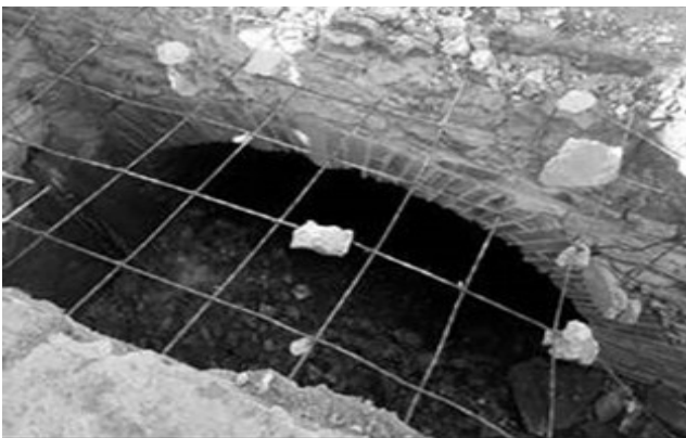
Foto 3. Colapso del ESR adjunto a la Escuela Primaria Fray Matías de Córdoba. (Elaboración propia)
